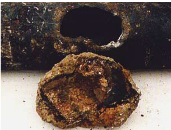
Korrosionsschaden an Rohrleitung
