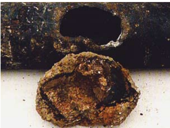
Korrosionsschaden an Rohrleitung
